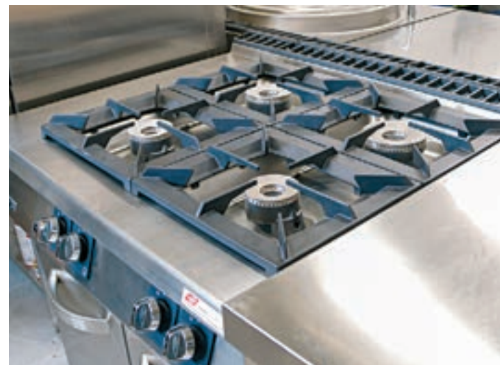
FOTO_ ACN Part de la instal·lació de gas de la cuina
