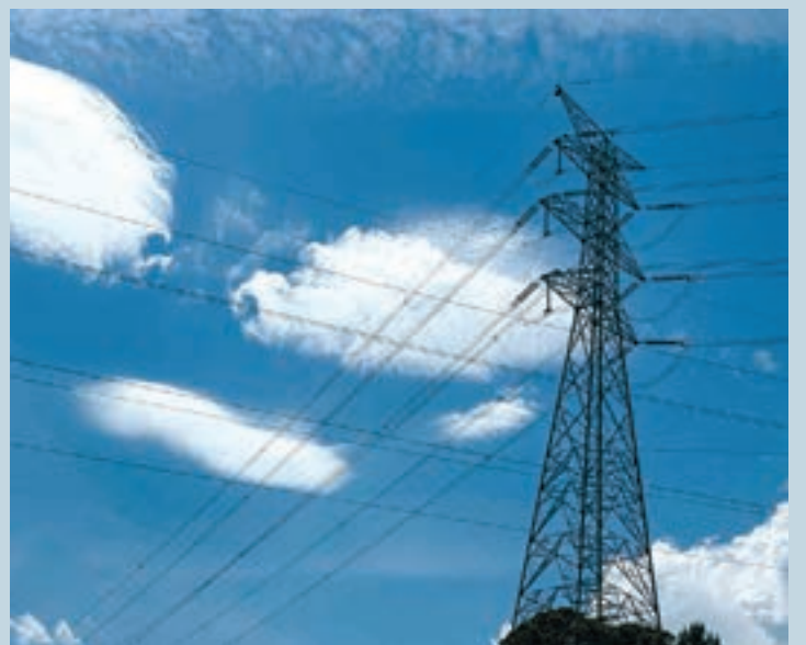
FOTO_ ACN Imatge d'arxiu d'una torre elèctrica
