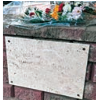
FOTO_ PP Imatge del mal estat de la placa dedicada al guàrdia civil
