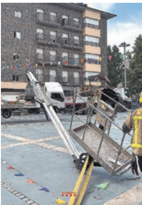
FOTO_Bombers El camió amb cistella elevadora bolcat
