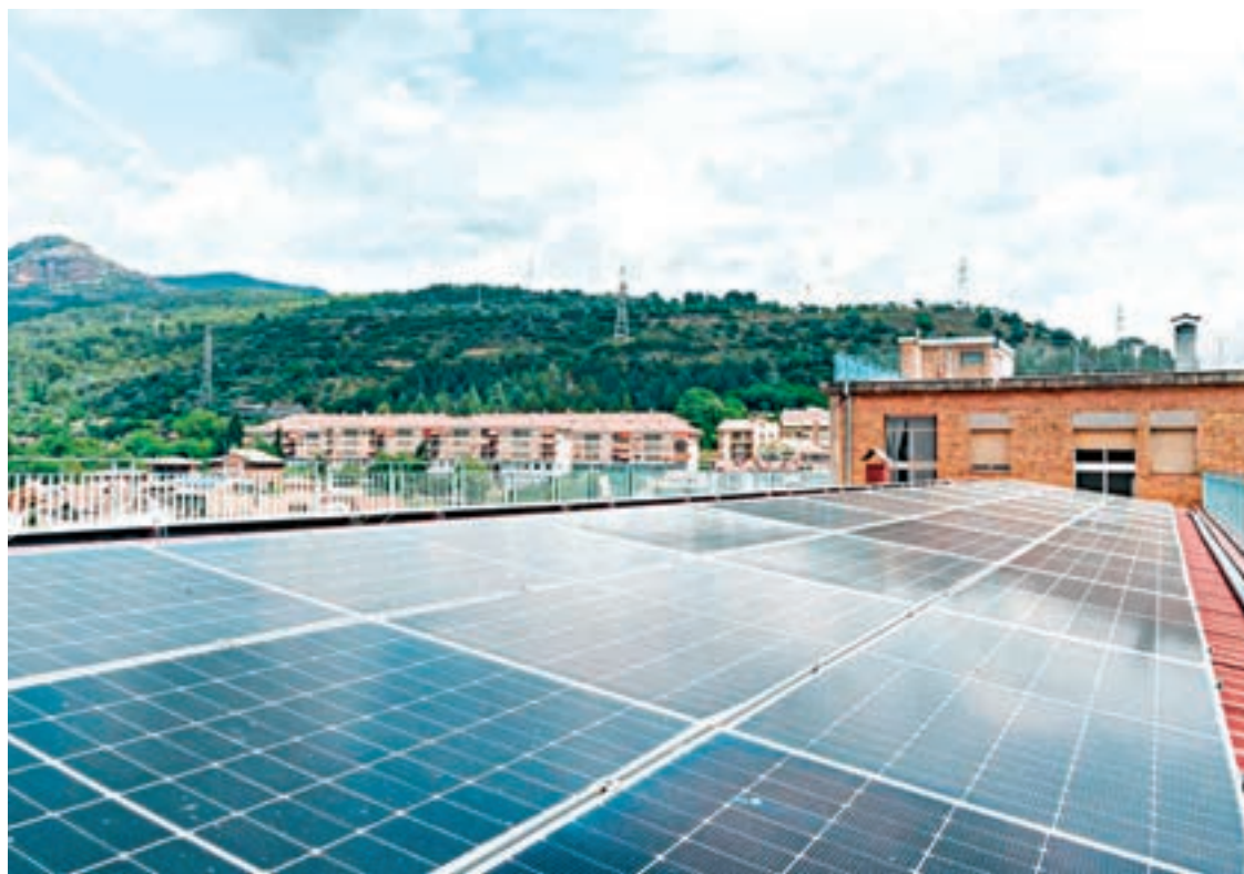
FOTO_ L'Energètica Plaques solars a la teulada de l'institut de la Pobla de Segur
