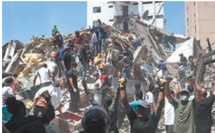
FOTO_ Ernesto Guzmán (EFE) Tasques de rescat en un edifici esfondrat a la ciutat de Cali
