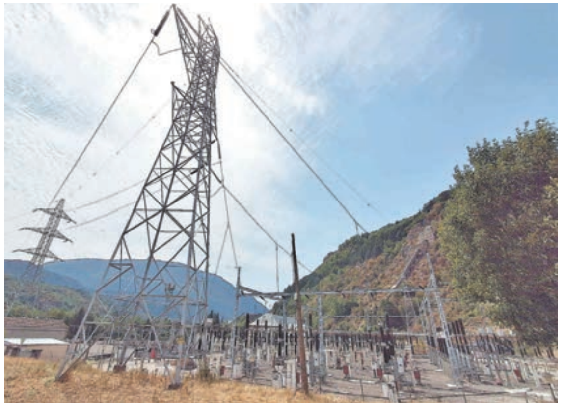
FOTO_ CCAR Imatge de les instal·lacions d'una hidroelèctrica
