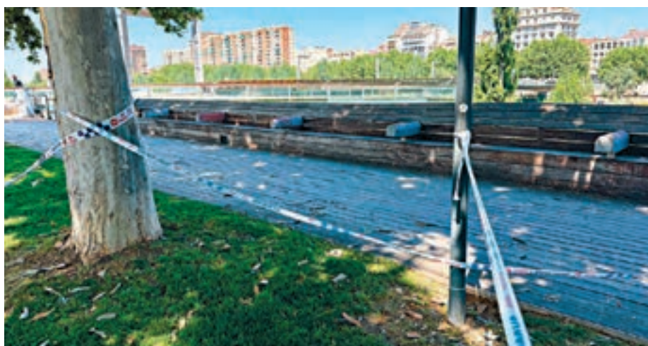
FOTO_ RafaPMedina Zona amb el terra de fusta en mal estat
