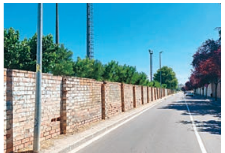
FOTO_ Aj. Tàrrega Aspecte del mur que es refarà
