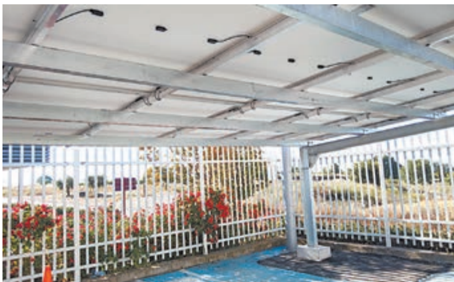
FOTO_ CREBA Nova instal·lació fotovoltaica a l'aparcament
