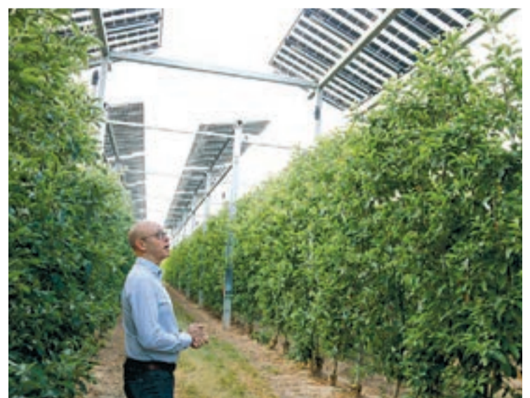
FOTO_ ACN Instal·lació en una finca de Mollerussa
