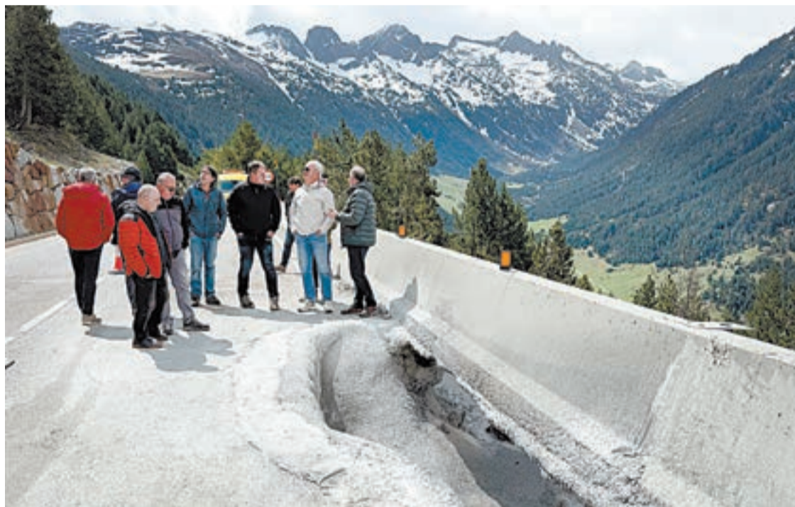
FOTO_ACN Alcaldes del Pallars Sobirà observant un dels punts que s'ha esfondrat
