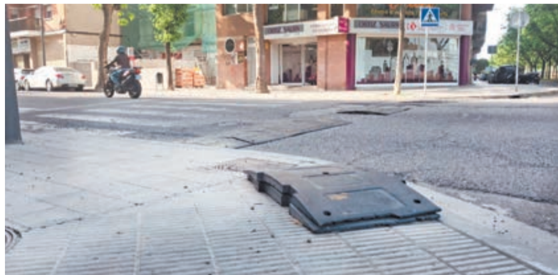
FOTO_ D. A. Les bandes rugoses per frenar la velocitat estan en mal estat
