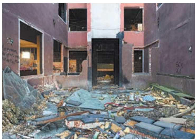
FOTO_ J.A. El deteriorament de l'espai és evident
