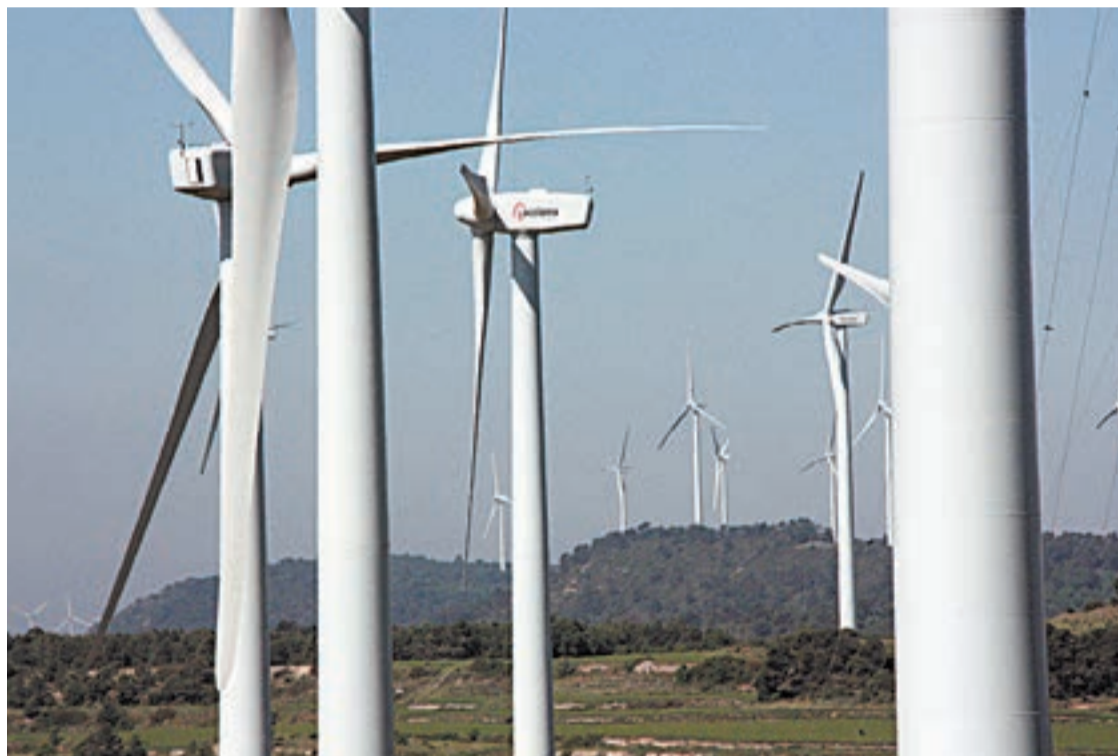
FOTO_AGN Pla general de molins de vent en un parc eòlic
