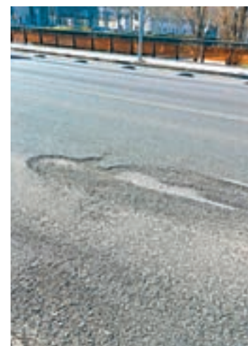
FOTO_PP Una de les zones que està en mal estat
