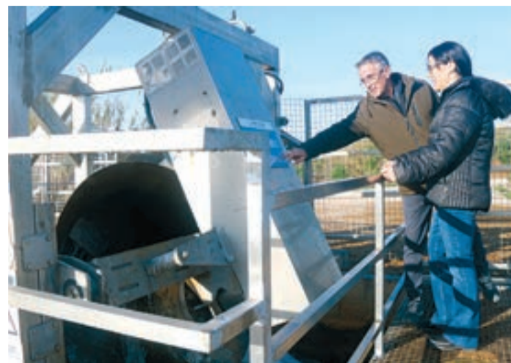
FOTO_ACN Estació de bombeig en una bassa de reg
