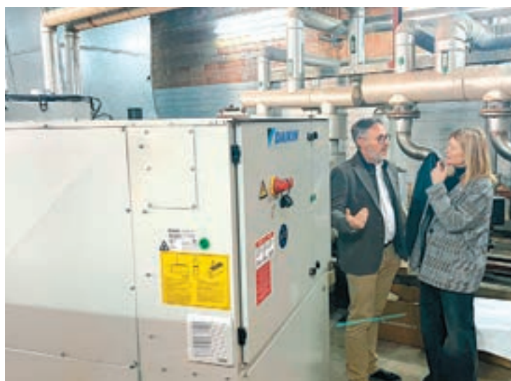
Iglesias observa la nova instal·lació climàtica de l'Auditori Enric Granados FOTO_ La Paeria
