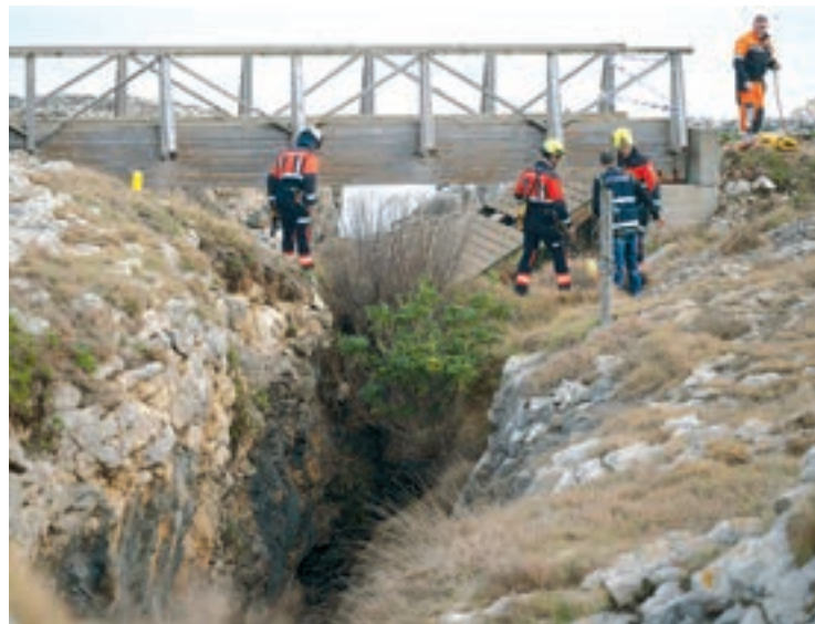
FOTO_ Pedro Puente Hoyos (EFE) Els Bombers inspeccionen la passarel·la de l'accident
