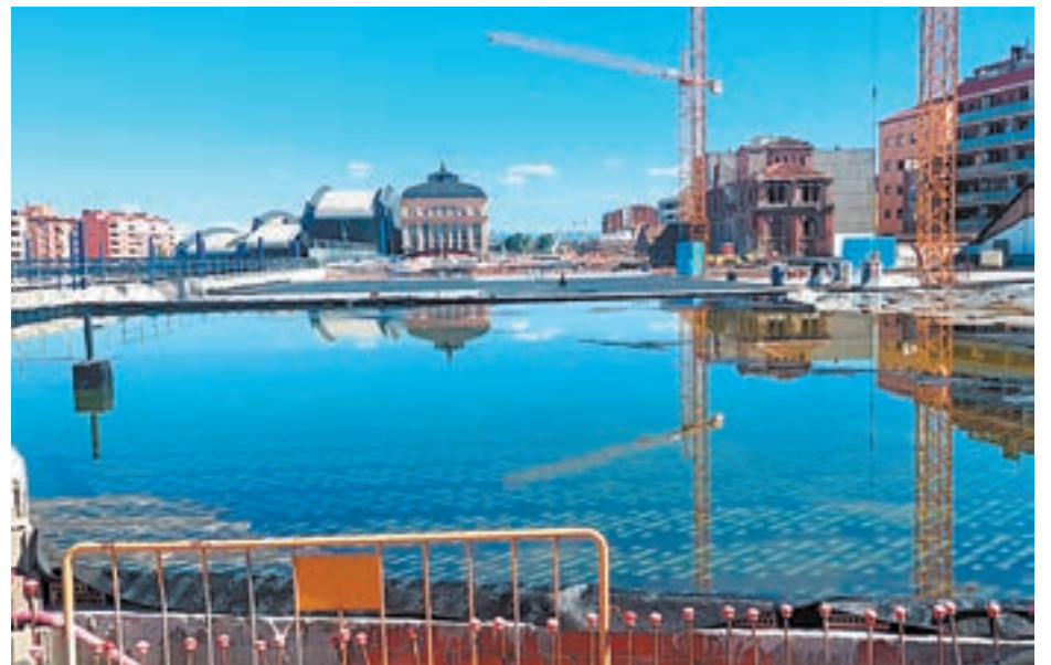
FOTO_ T.A. Prova de filtratge d'aigua al sostre de Comtes d'Urgell
