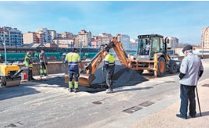
FOTO_ D.A. Operaris treballen a la zona afectada
