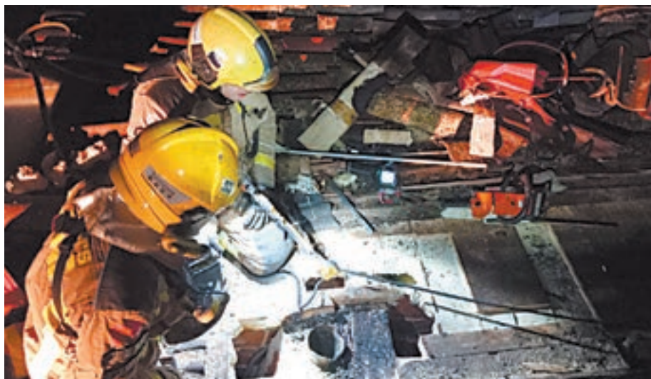
FOTO_ Bombers Revisió dels forjats amb una càmera tèrmica
