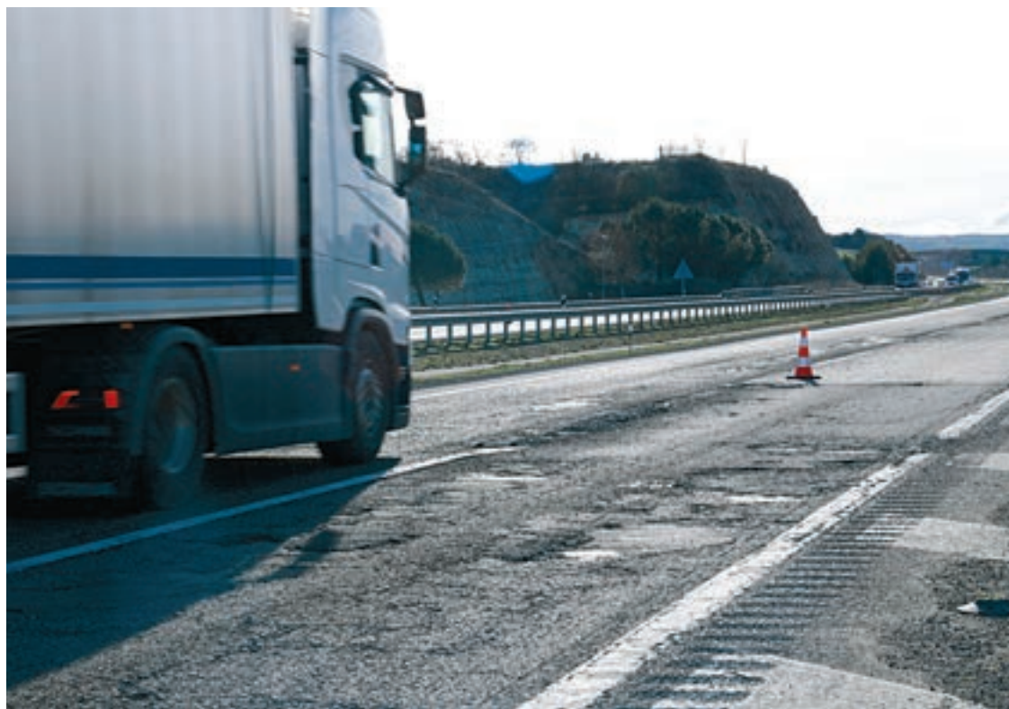
FOTO_ACN Un camió circulant per l'autovia A-2 amb el paviment en mal estat
