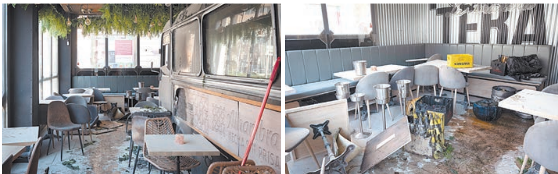
FOTO_ Jorge Agustín La zona de cafeteria va quedar afectada pel foc i el fum arran de l'incendi inicial de dos congeladors de l'establiment
