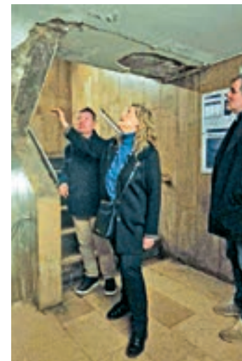
FOTO_ Juntscat Paeria Desperfectes en un accés a l'aparcament
