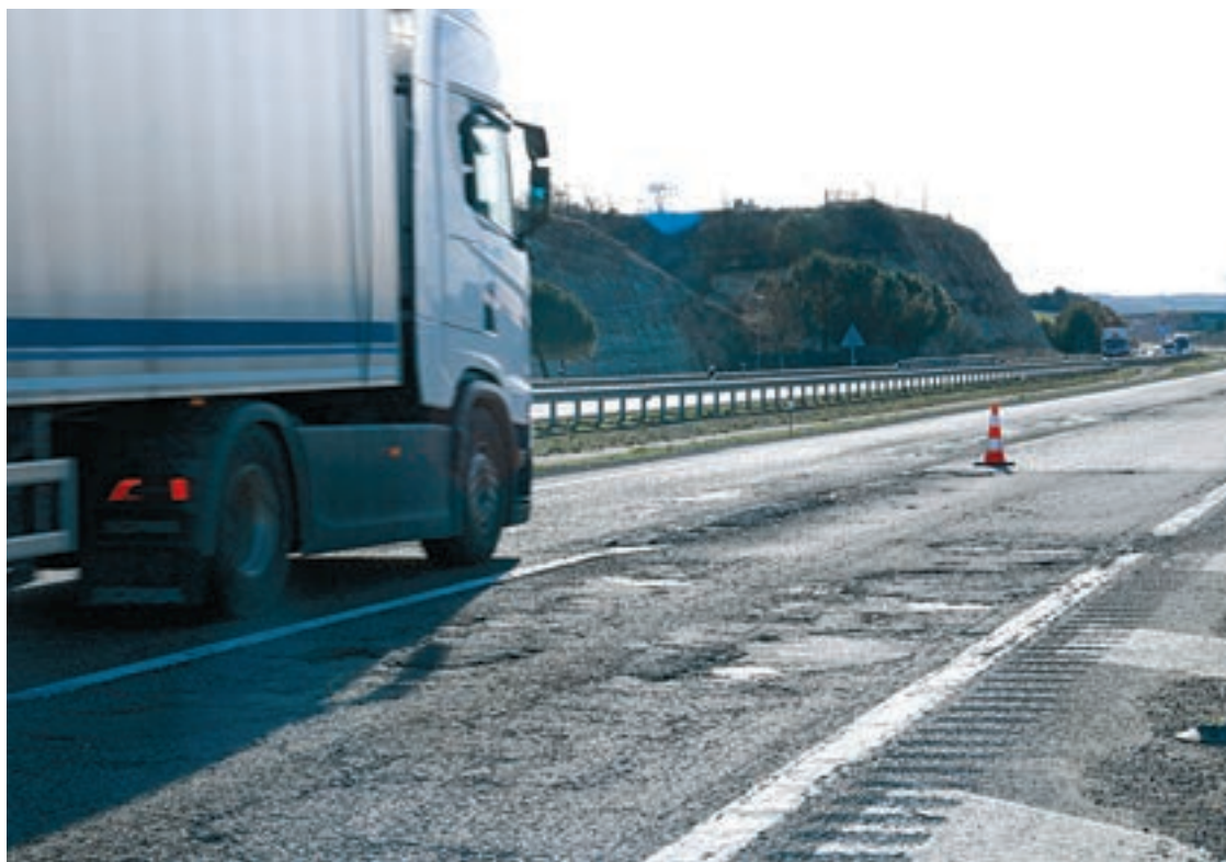
FOTO_ACN Imatge del ferm de l'A-2 en mal estat, prop de Cervera
