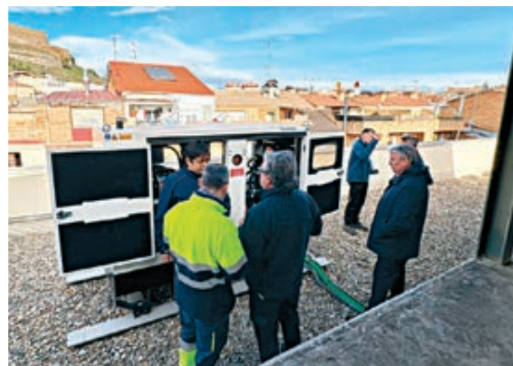
FOTO_ Diputació El nou grup electrogen s'ha instal·lat a la coberta de l'edifici de Rambla Ferran, 19
