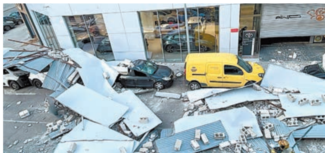
FOTO_ACN Caiguda d'una coberta i d'un mur d'un taller a l'Hospitalet
