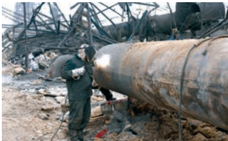
FOTO_EPA Treballadors ucraïnesos reparen una central tèrmica després d'un bombardeig de Rússia
