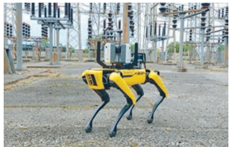
FOTO_Endesa Robot equipat amb una càmera especial per enregistrar infraestructures en una subestació
