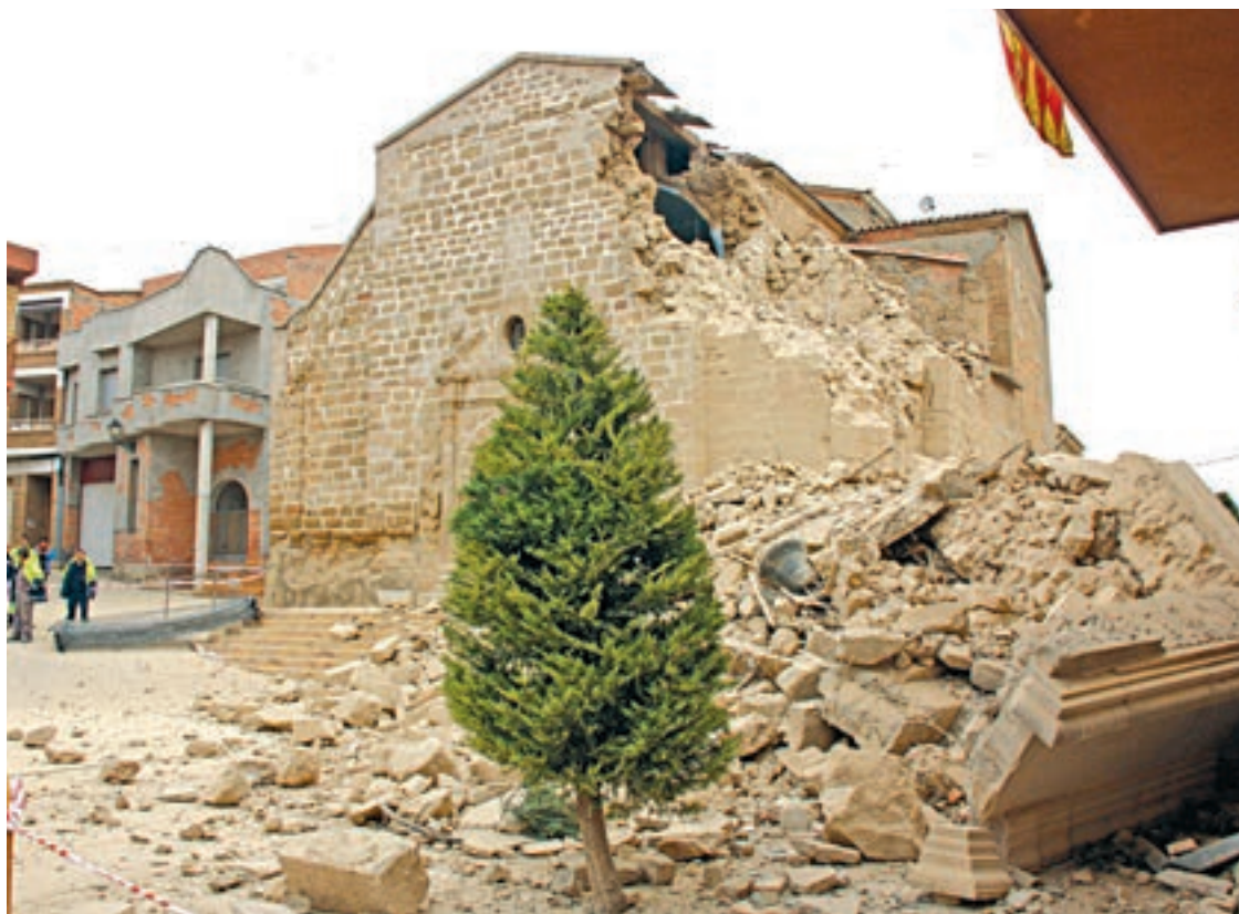
FOTO_ ACN Imatge del lateral de l’església després de l’esfondrament del campanar
