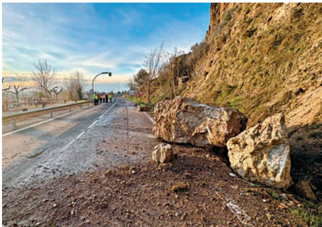
FOTO_ Diputació Roques de grans dimensions a la carretera per l'esllavissada
