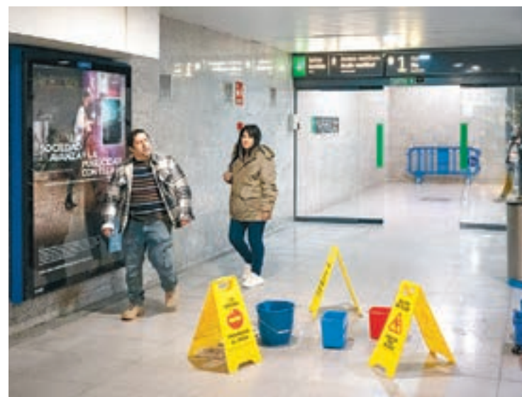
FOTO_J.A. Goteres al subterrani de l'estació de Lleida
