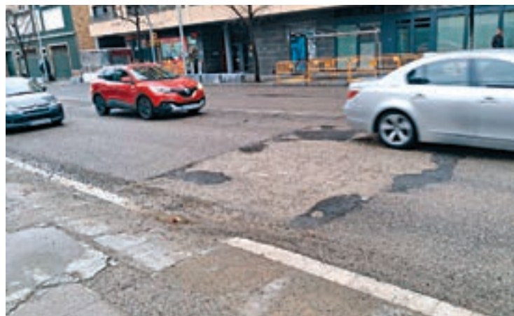
FOTO_ D.A. Un dels trams que s'asfaltaran i que ha estat danyat per les obres
