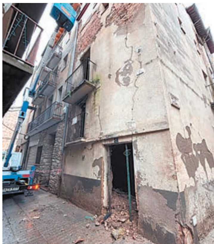
FOTO_Aj. Tremp Un dels immobles a enderrocar
