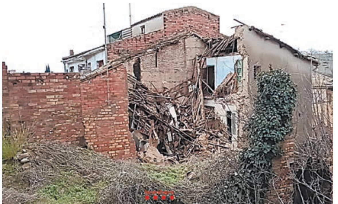
FOTO_ Bombers Estat en què va quedar la casa després de l'esfondrament
