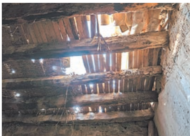
FOTO_ Jorge Agustín El sostre, deteriorat i trencat
