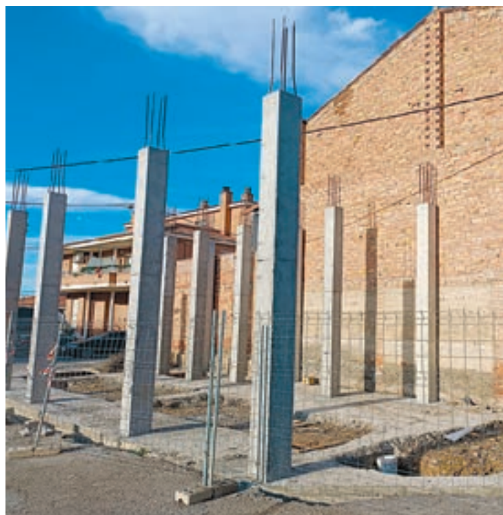
FOTO_L.M. La línia elèctrica 'creua' el solar al carrer Portal de Vilanova
