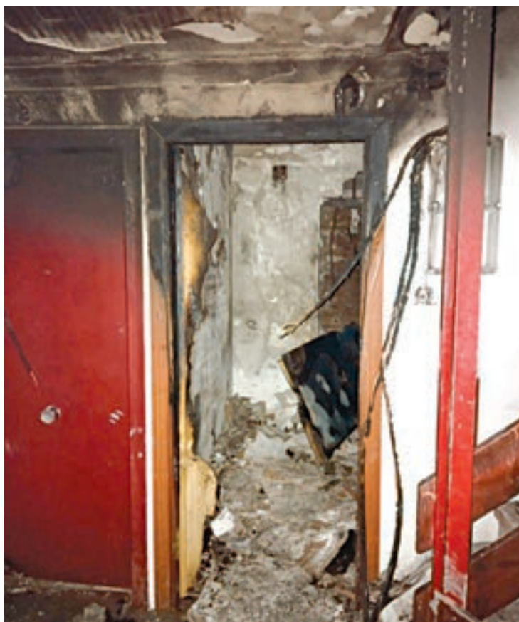
FOTO_L.M. Replà de l'entrada al pis afectat pel foc
