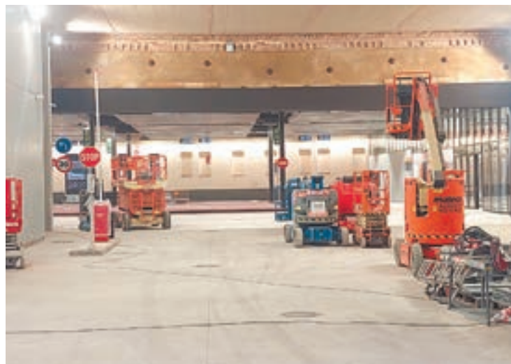
FOTO_T. Alcántara Maquinària dintre de l'edifici
