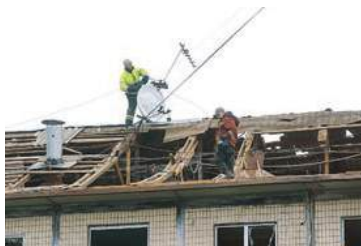
FOTO_ Sergey Dolzhenko (EFE) Danys en un edifici de Kiïv provocats per l'atac de drons russos
