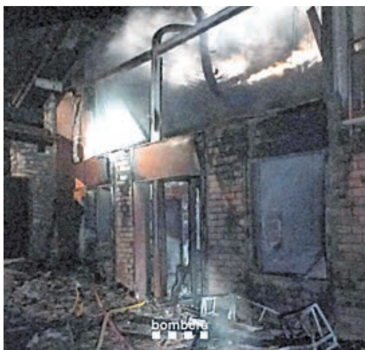
FOTO_ Bombers La casa calcinada de la plaça Major
