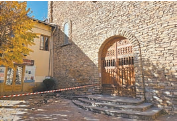
FOTO_ACN Imatge de les pedres que van caure
