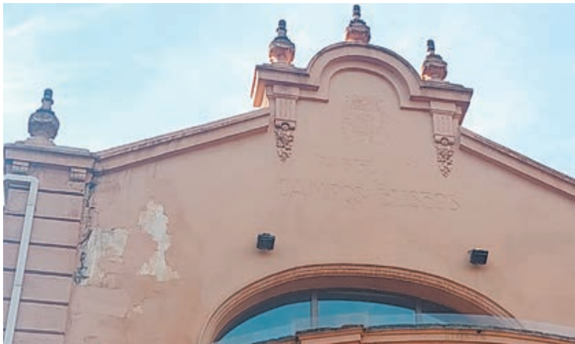
FOTO_ Tony Alcántara La façana deteriorada de l'antic cafè-teatre dels Camps Elisis
