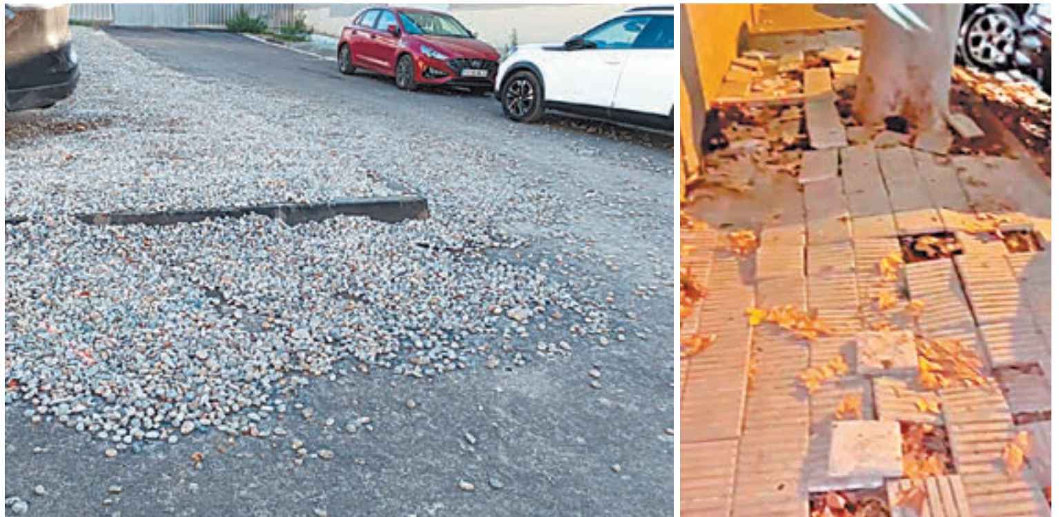
FOTO_L.M. / PP Pedres escampades per la calçada del carrer Sícoris i, a la dreta, tram de vorera fet malbé
