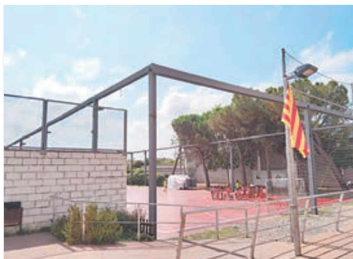
FOTO_ L.M. Estat de la pista poliesportiva, on encara es veu l'estructura de la coberta que va caure
