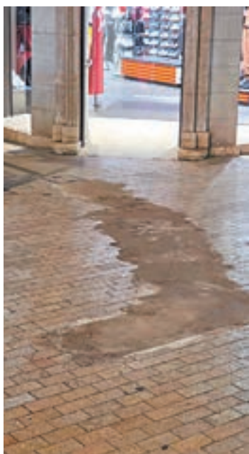
FOTO_ PP Imatge de la rasa tapada amb ciment
