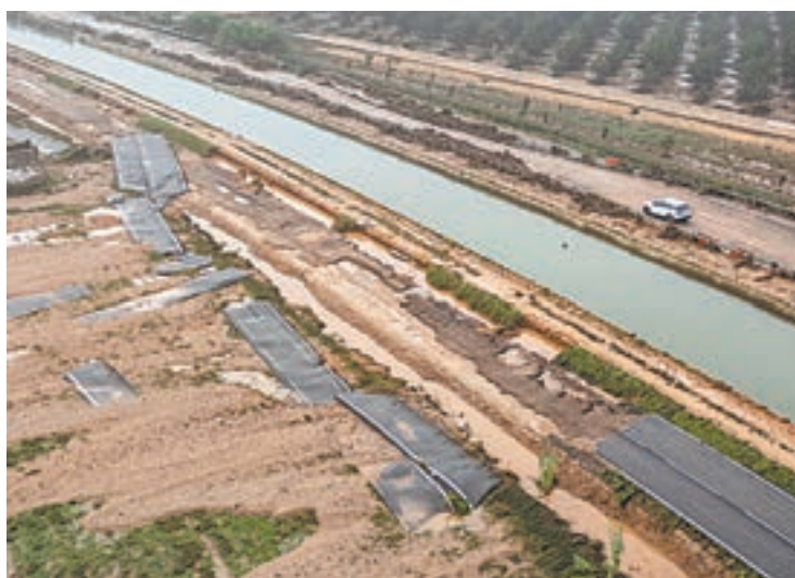
FOTO_ Jordi Borràs (EFE) Desperfectes a la carretera TV-3443 entre Tortosa i Amposta
