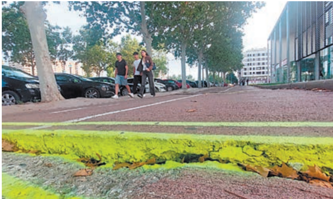
FOTO_ Tony Alcántara Tram del passeig per a vianants i ciclistes en mal estat
