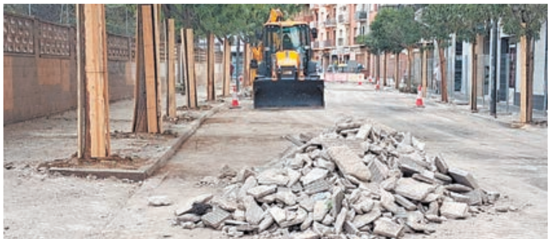
FOTO_ D.A. Una excavadora i part del material de les voreres del carrer
