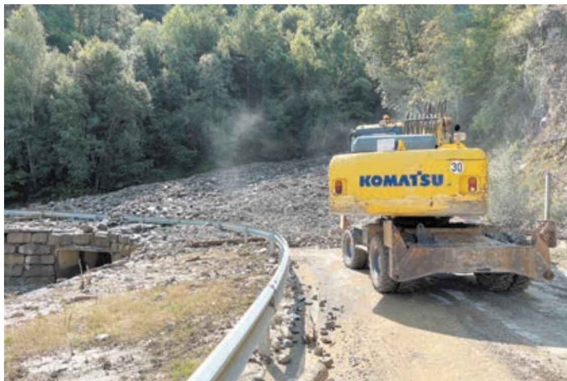
FOTO_ACN Una màquina treballant per retirar el material caigut a la carretera
