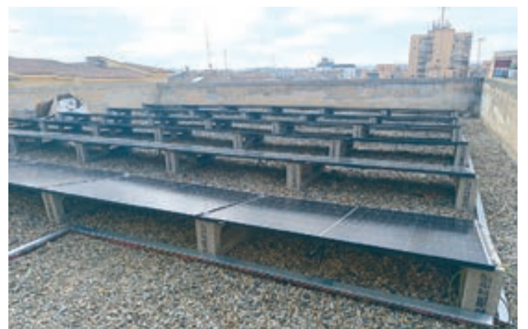
FOTO_ La Paeria L'Ajuntament de Lleida ha instal·lat noves plaques fotovoltaïques
