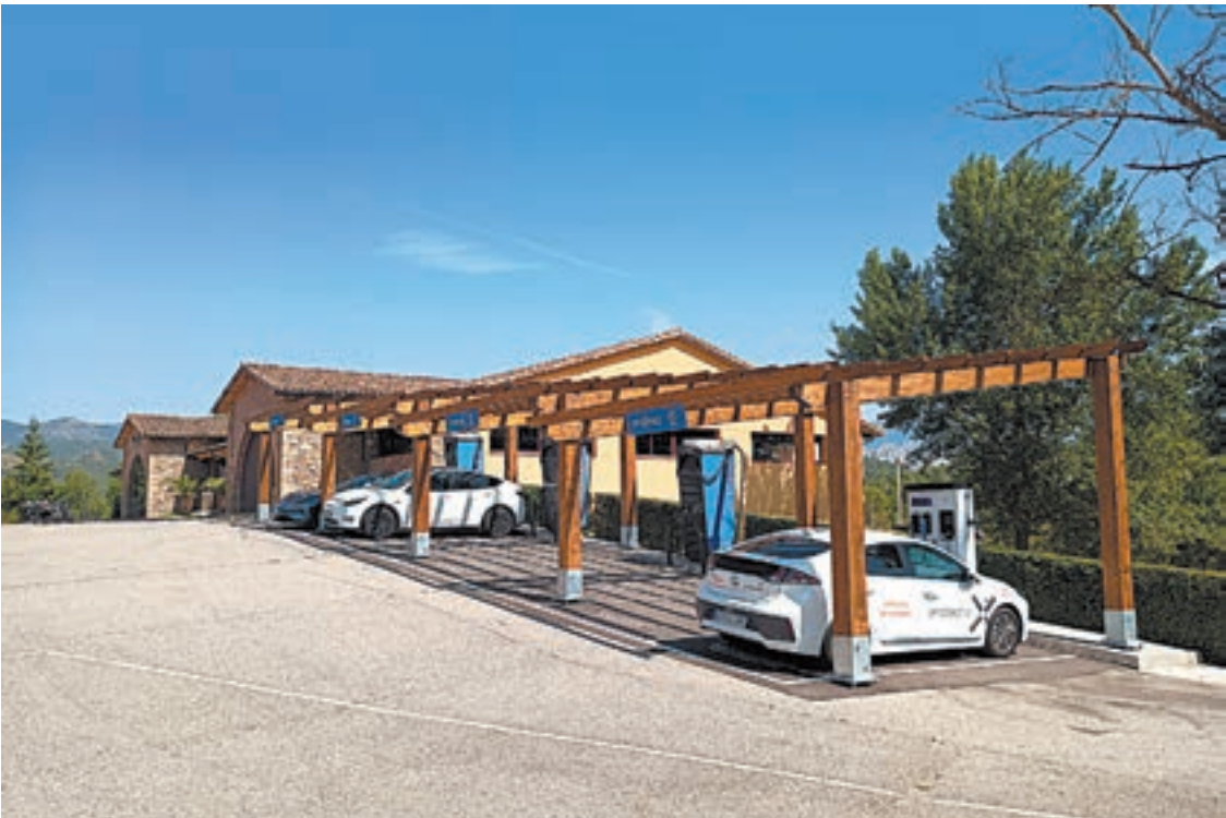
FOTO_ Endesa El nou hub de recàrrega està instal·lat a BaSSella Experience
