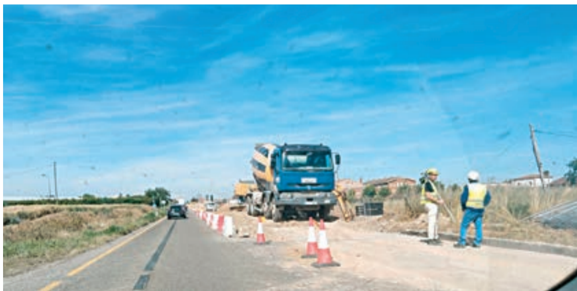
FOTO_ D.A. Tram afectat per les obres de la línia d'evacuació elèctrica
