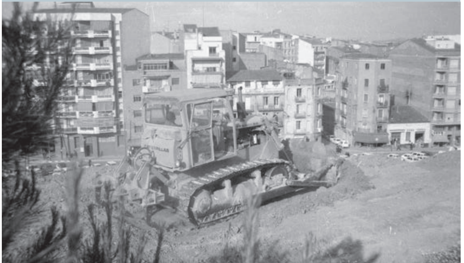
Una màquina excavadora remou la terra al vessant nord del Turó de la Seu Vella / Fons Gómez Vidal (sense datar)
