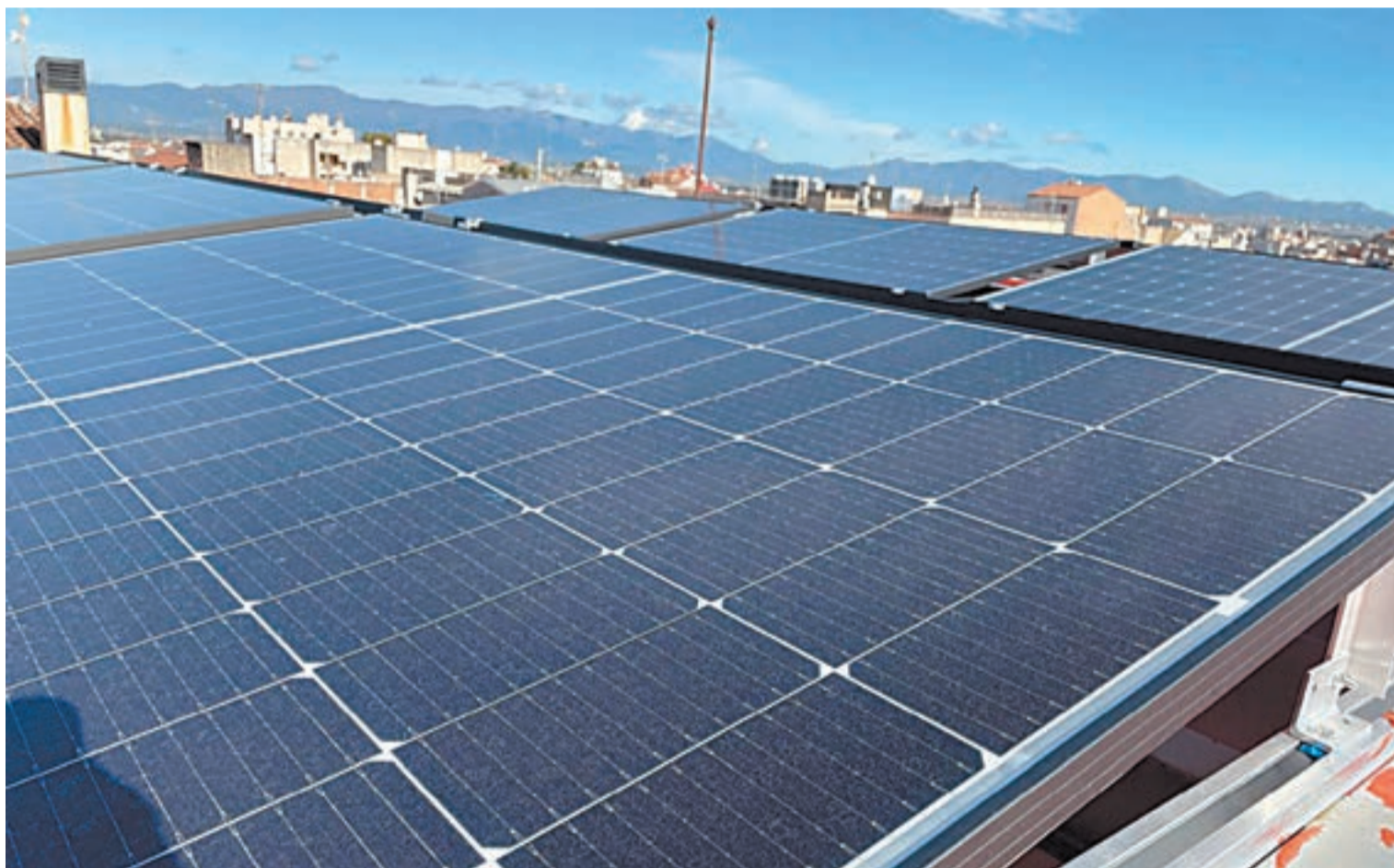
FOTO_ACN Imatge d'una instal·lació fotovoltaica sobre el teulat d'un edifici
