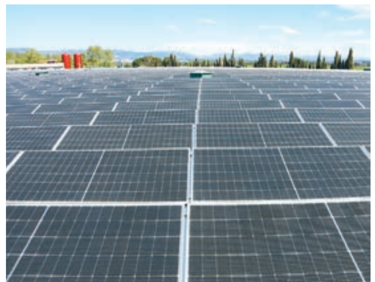
FOTO_ACN Una instal·lació fotovoltaica a Constantí
