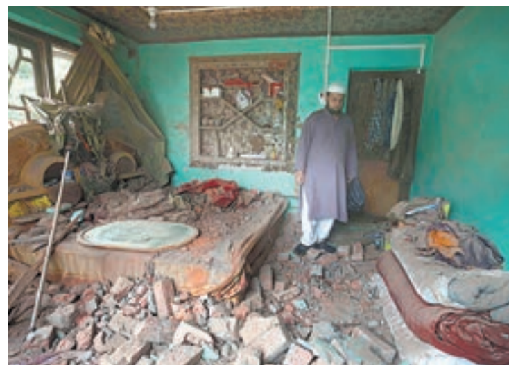
FOTO_EFE Un vilatà de Caixmir inspecciona una casa danyada pels bombardejos
