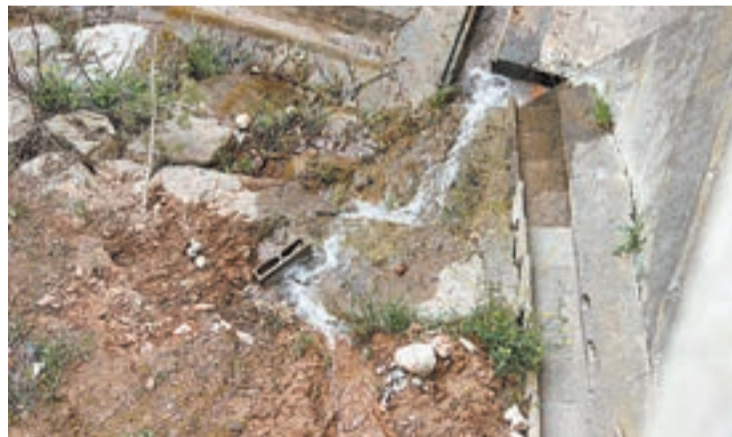
FOTO_T.A. La filtració d'aigua s'ha reduït en dos dies
